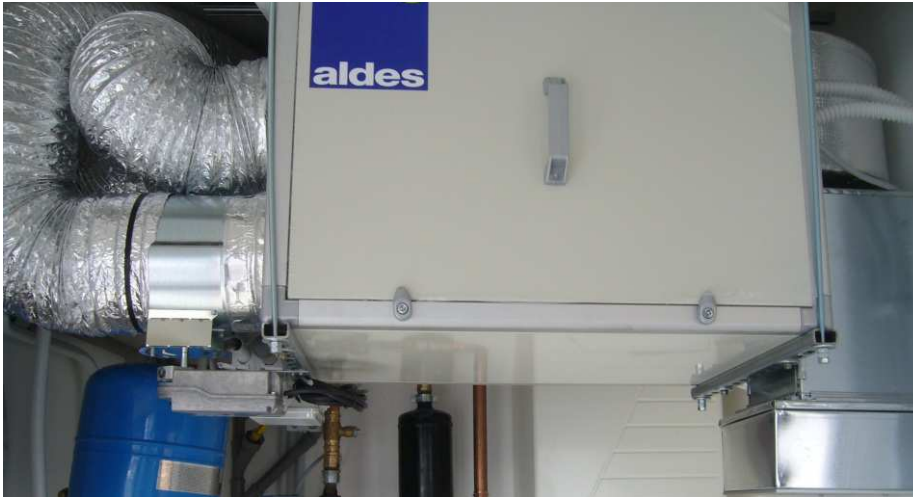
Ventilazione meccanica (portata massima 470 m 3 /h) con recuperatore di calore (>90%)
